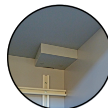
Orifices de ventilation avec thermofusible
